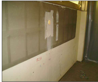
Wandbekleidung mit asbesthaltigen Spachtelmassen
