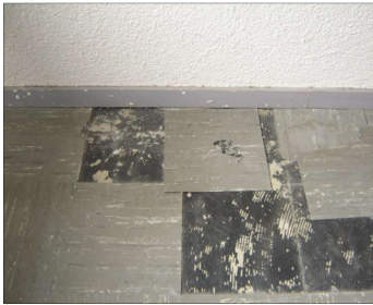
Flor-Flexplatten mit asbesthaltigem Kleber
